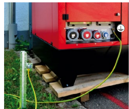
Abb. 15 Stromerzeuger mit Erdungsanschluss und Erdspieß
