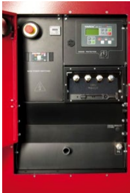
Abb. 16 Stromerzeuger mit Überschutz, aber ohne integrierte Maßnahmen zum Personenschutz
