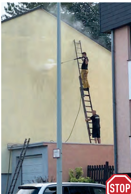
Abb. 2: So nicht! (Quelle: Dirk Oehme, BG BAU)
