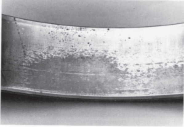
Écaillage du chemin de roulement
