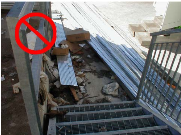
Scale ostruite da materiali
