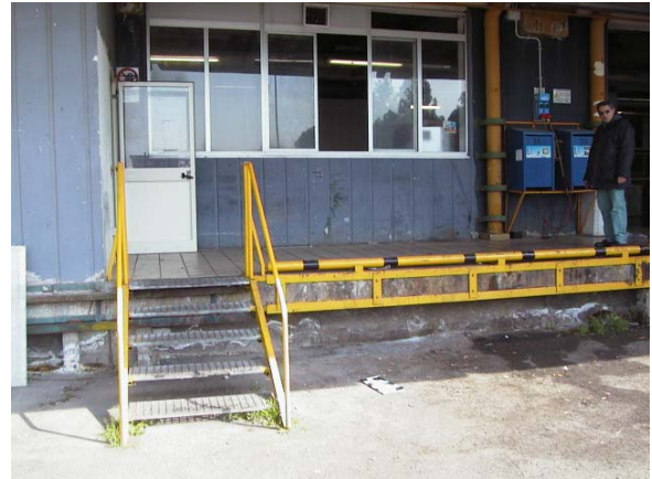
Bordi di protezione per evitare cadute di veicoli
