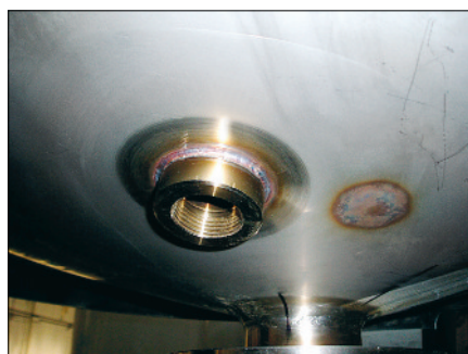
Fig. 7 Effetto dell'impiego di paste decapanti su cordoni di saldatura: una scatola metallica (in alto) e un serbatoio di stoccaggio (in basso). [per cortesia della società Azzini S.p.A., Soresina (CR)]. Effect of the use of pickling pastes on lines of welding: a metal box (top) and a stocking tank (low). [Source: company Azzini S.p.A., Soresina (CR)].
