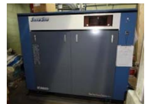
▲小型蒸気圧縮機 (低圧蒸気再利用)
