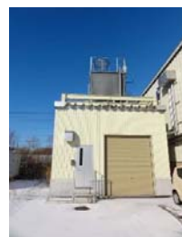
▲高効率水冷式自然冷媒冷凍機用 建屋
