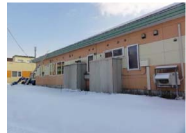
▲地中熱ヒートポンプ収納ユニット
