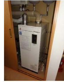
▲既存の灯油ボイラー
