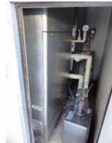
▲地中熱ヒートポンプ
