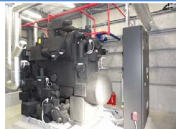
▲高効率水冷式自然冷媒冷凍機
