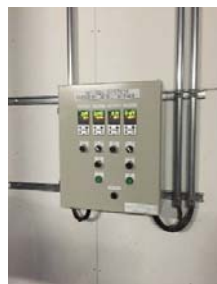
▲冷凍機電子圧力制御盤
