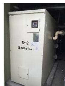
▲都市ガスボイラー
