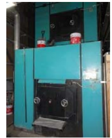
▲バイオマスボイラー
