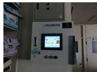
▲冷凍設備監視盤
