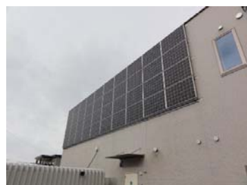
▲壁面垂直型太陽光発電モジュール
