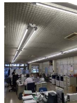
▲事務所内のLED照明
