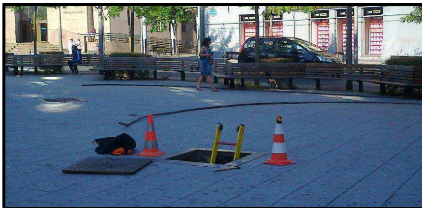
Recinto confinado deficientemente señalizado
