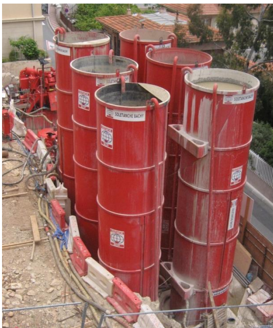
Fig. 2.2.4. Réservoirs de bentonite
