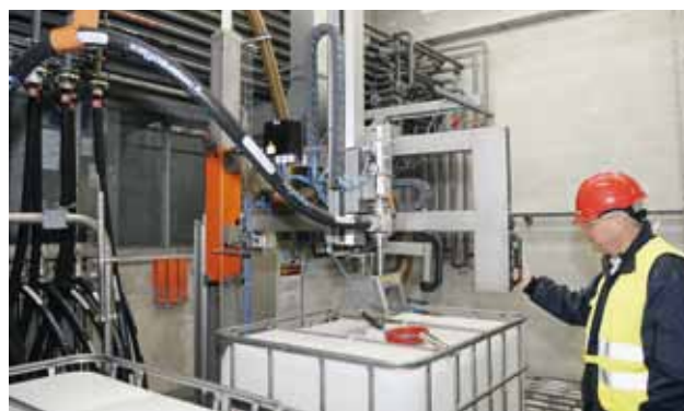
18 Stazione semiautomatica di riempimento barili con dispositivo di aspirazione all'uscita
