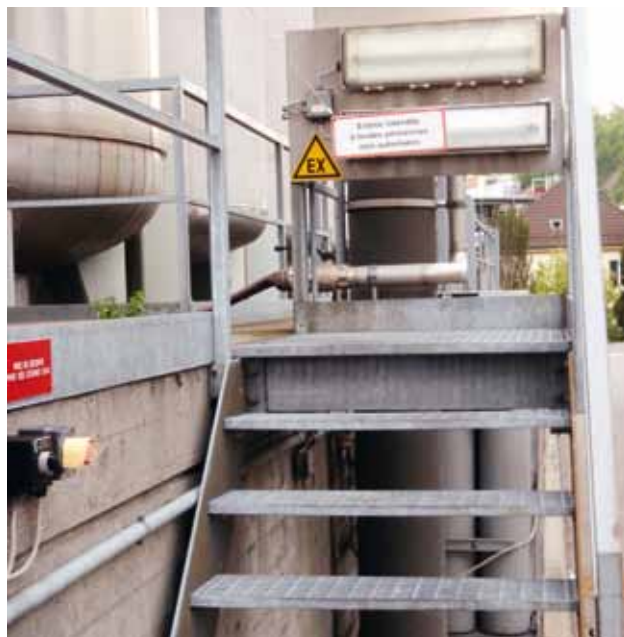
23 All'interno delle zone a rischio di esplosione è vietato introdurre fonti di innesco. Le zone devono essere contrassegnate con i cartelli «EX».
